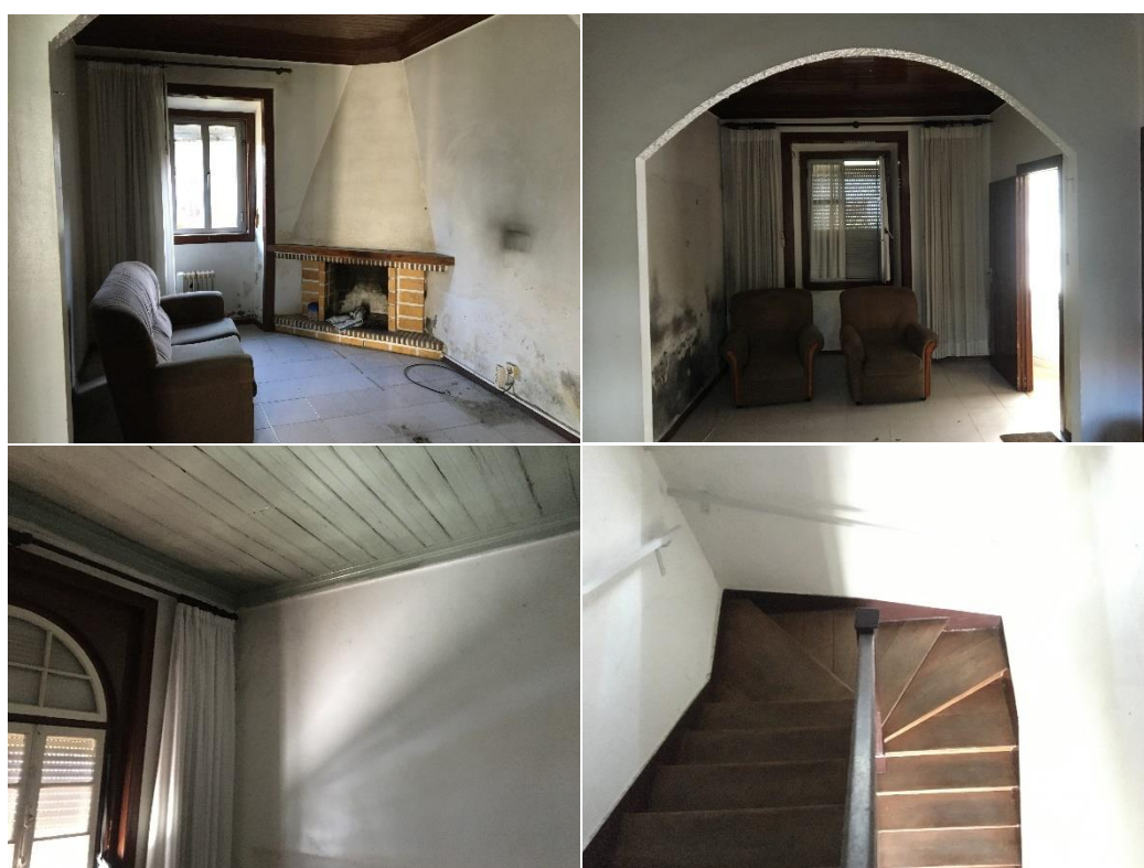
Figura 15 – Interiores do edificado, onde se denota o estado de degradação das suas estruturas e acabamentos;
