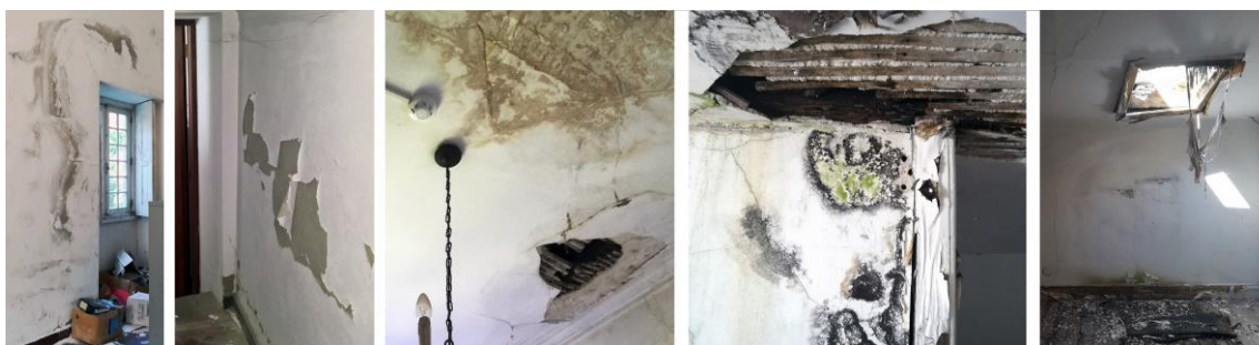
Figura 35 – Fotografias das patologias relacionadas com a humidade.
