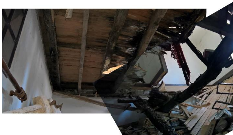
Figura 36 - Rotura da estrutura de piso, em cima vista desde o piso 1, em baixo vista desde o piso térreo.
