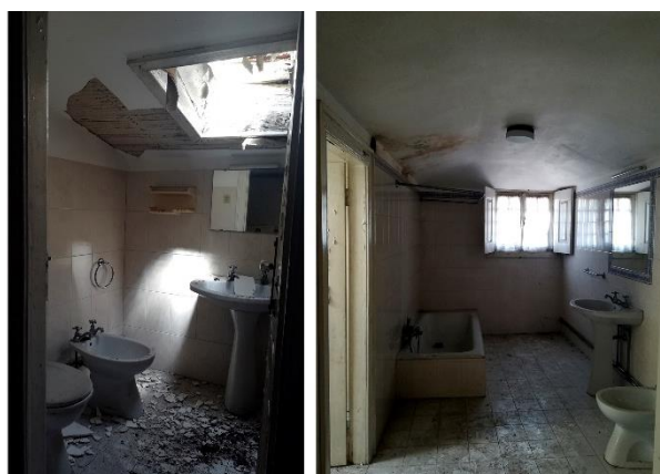
Figura 203 - Casas de banho do piso 2 iluminadas por claraboia e janela da trapeira.
