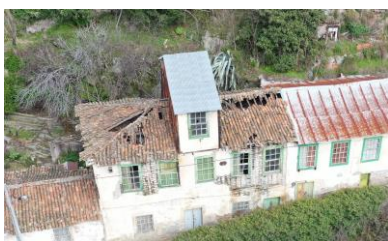
Figura 44- estrutura inadequada do edifício 4 (fonte: drone da UBI)
