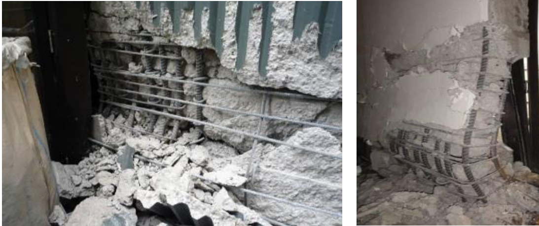
Figura 1: Danos em paredes resistentes com encurvadura das armaduras no limite inferior (adaptado de [2]).
