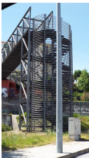
Fig. 27 - Escadas do Jardim do Rodrigo sobre linha férrea não acessíveis (Fonte: autor. 2015)
