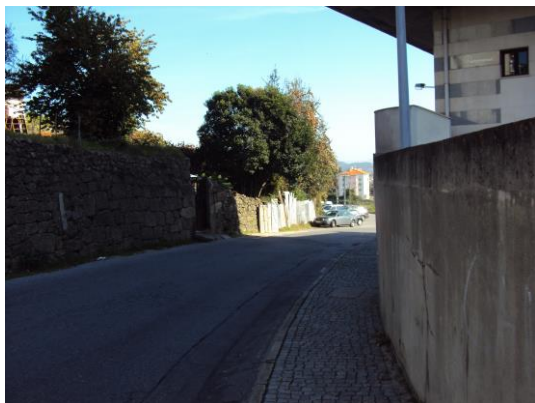
Fig. 20 - Ausência de guardas no muro que delimita o passeio para peões (Fonte: autor. 2014)
