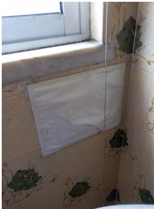
Figura 75 - Grelha de admissão de ar obstruída
