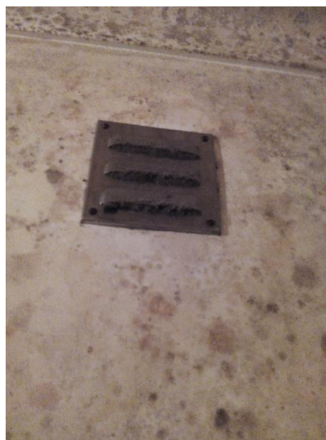
Figura 73 - Pormenor da obstrução da grelha de ventilação
