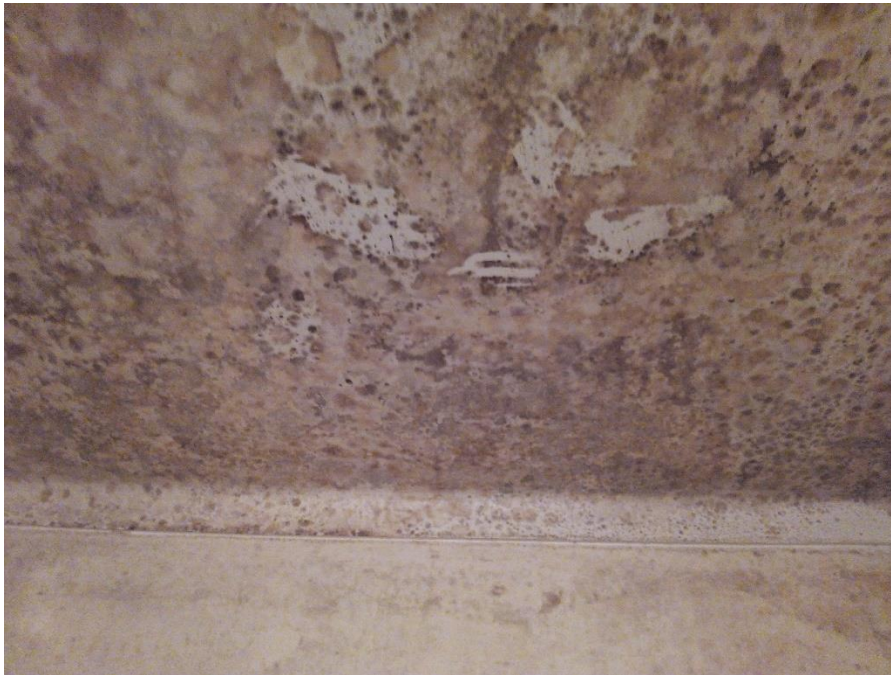
Figura 72 - Pormenor da degradação do teto
