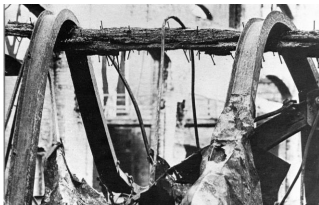
Figura 2.13 - Viga de madeira a suportar dois perfis de aço após incêndio 1
