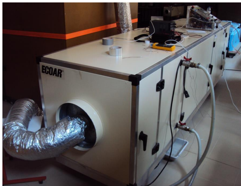
Figura 5.3 - Evaporador da unidade de tratamento de ar.
