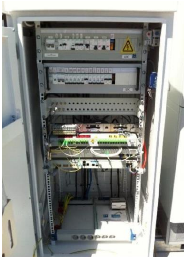
Figura 3.4 - Armário ABE_V2, comportando equipamentos de telecomunicações em funcionamento.
