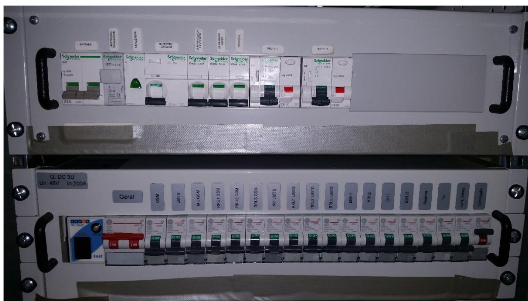
Figura 3.3 - Quadros elétricos, AC no topo e DC na posição inferior.
