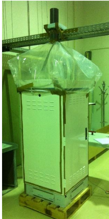
Figura 3.26 - Armário com a campânula localizada do topo da estrutura do armário.
