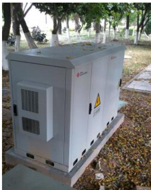
Figura 2.8 - Armário exterior comportando uma unidade externa de ar condicionado (ESTEL, s.d.).
