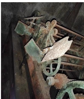
(b) Mecanismo mecânico anterior à instalação do mecanismo eletromecânico.
