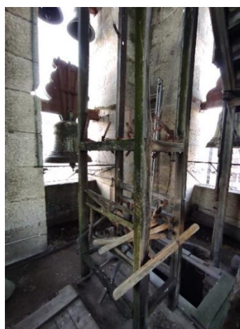
(e) Teclado do Carrilhão da Torre, em estado avançado de deterioração.
