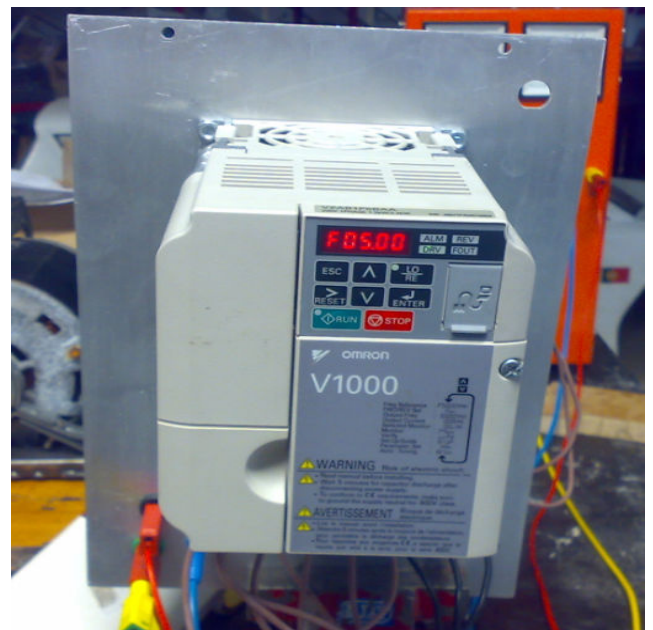
Fig.19. Variador de frequência
