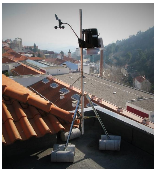
Figura 3.23 - Estação meteorológica Davis Wireless Vantage Pro 2 do edifício das Engenharias da UBI.
