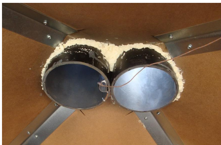
Figura 3.26 - Termopar tipo T colocado à entrada da chaminé.
