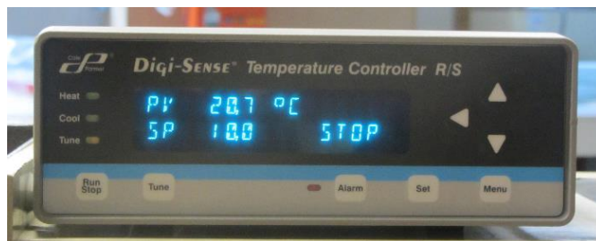
Figura 3.5 Controlador de temperatura da unidade de AC
