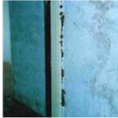
Figura 30 - Fungos no interior dos edifícios. [37]
