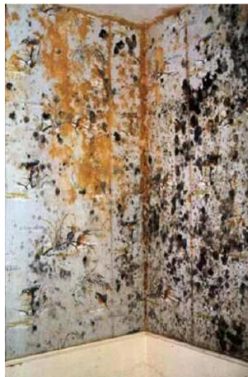
Figura 27 - Manchas de humidade (bolor). [27]
