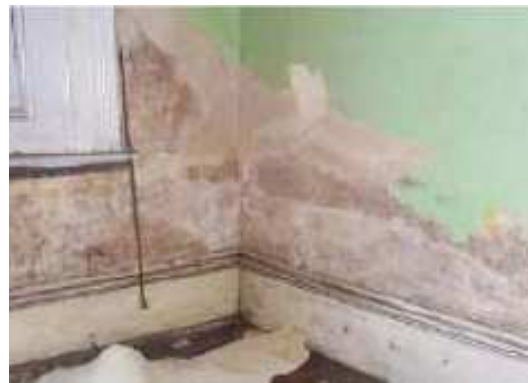
Figura 14 - Manchas brancas nas paredes. [27]
