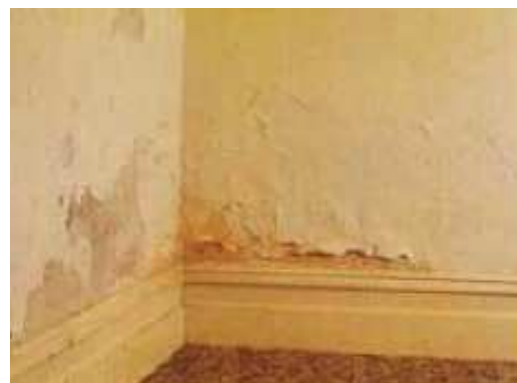
Figura 15 - Deterioração do estuque. [27]
