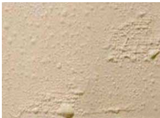
Figura 16 - Bolhas sob a tinta das paredes. [28]
