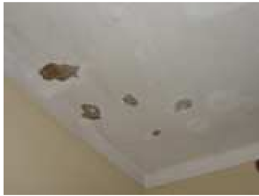
Figura 13 - Mancha escura no tecto. [26]
