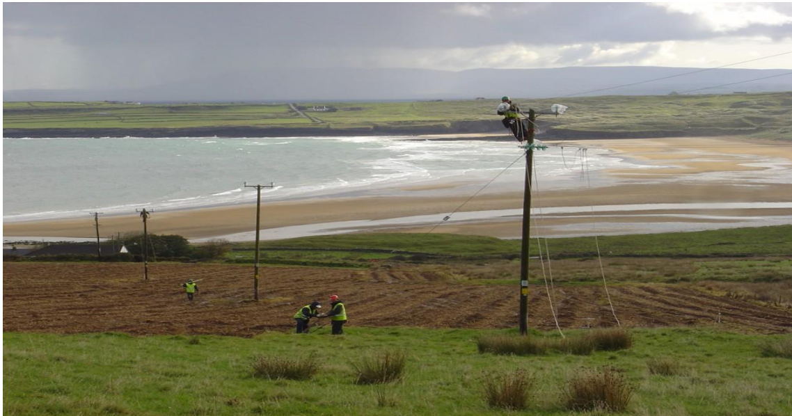
Figura 3 - Linhas de energia eléctrica.
