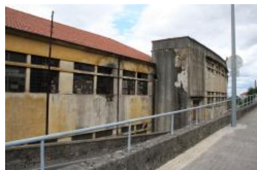
Fig.68 Sinais de degradação.
