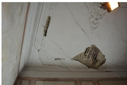
Figura 140 - Estuque trabalhado com falhas e fissuras
