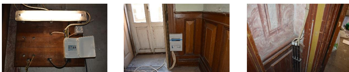
Figura 155 - Instalações elétricas à vista e em mau estado
