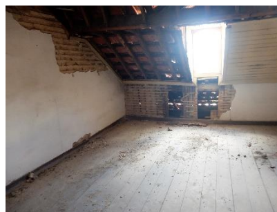
Figura 126 - Compartimento em mau estado de conservação com janela
