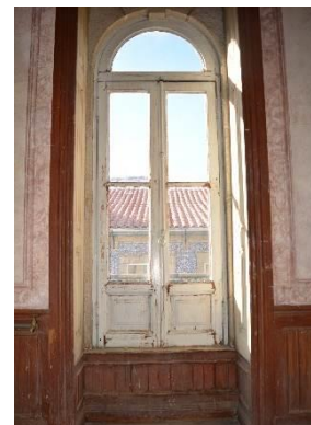
Figura 147 - Rodapé, moldura e caixilharia de madeira com grande desgaste.
