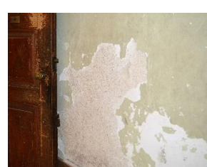
Figura 134 - Falhas no revestimento de uma parede interior
