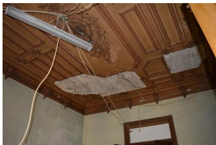
Figura 138 - Revestimento de madeira degradado
