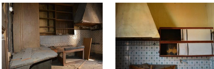
Figura 157 - Mobiliário das duas cozinhas em mau estado de conservação
