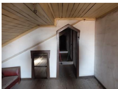
Figura 128 - Diferença da altura de portas
