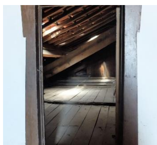
Figura 129 - Cobertura sem revestimento interior e com falhas de telhas
