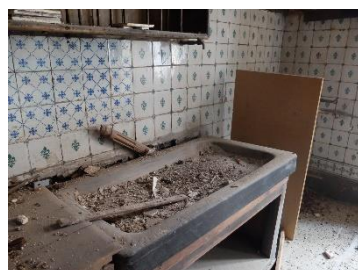
Figura 94 - Degradação visível nos móveis
