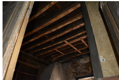
Figura 139 - estrutura de madeira a vista, com estado de degradação avançado (cozinha)
