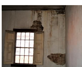
Figura 133 - Humidade e falhas no estuque
