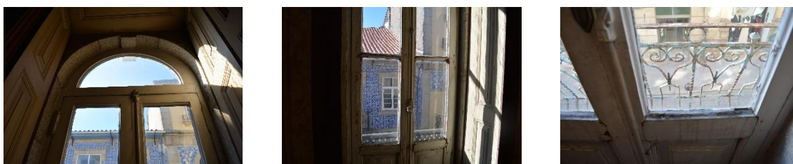
Figura 148 - Caixilharia das janelas com algum desgaste
