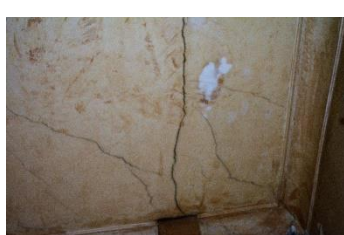
Figura 132 - Fissuras numa parede interior
