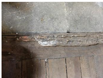
Figura 136 - Pavimento de madeira com desgaste
