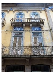
Figura 131 - Humidade visível na fachada principal
