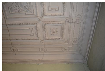
Figura 141 - Teto com estuque trabalhado, com fissuras de espessura considerável
