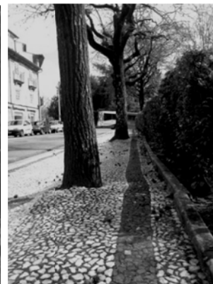
fig. 52 - mau estado do pavimento na alameda
