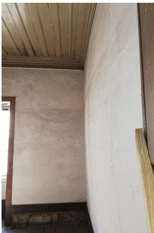
B26 – Parede abaulada
