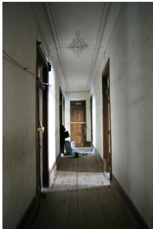
B18 – Desnível do pavimento
