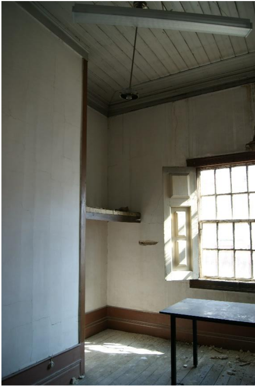
C16 – Muita fendilhação na zona da escada
