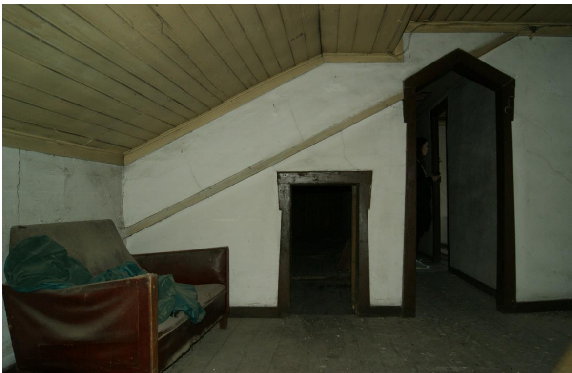
DO2 – Zona muito degradada
