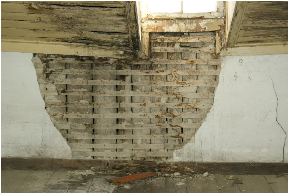
DO6 – Apodrecimento das madeiras por infiltrações
