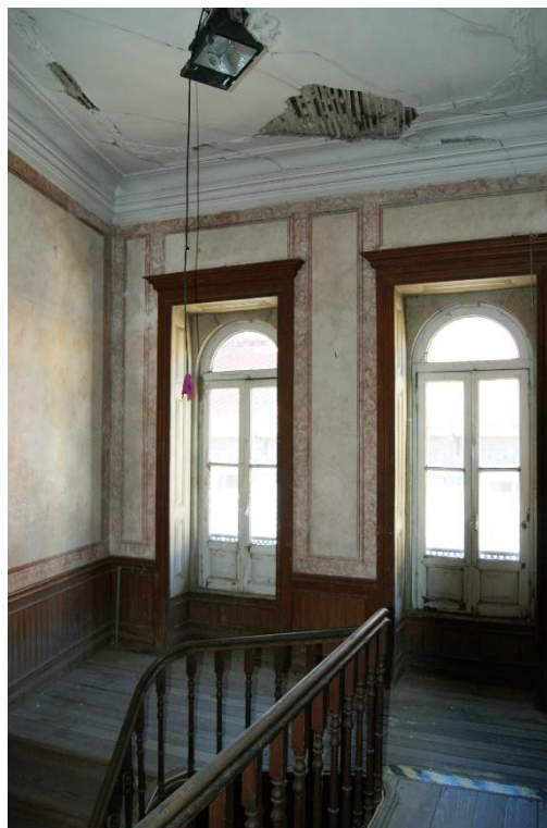
C24 – Desgaste do ultimo piso
