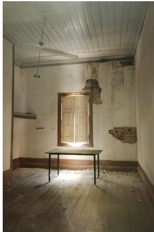
C15 – Infiltrações em parede tabique
