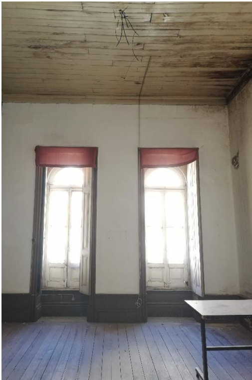
Co8 – Infiltração no teto
