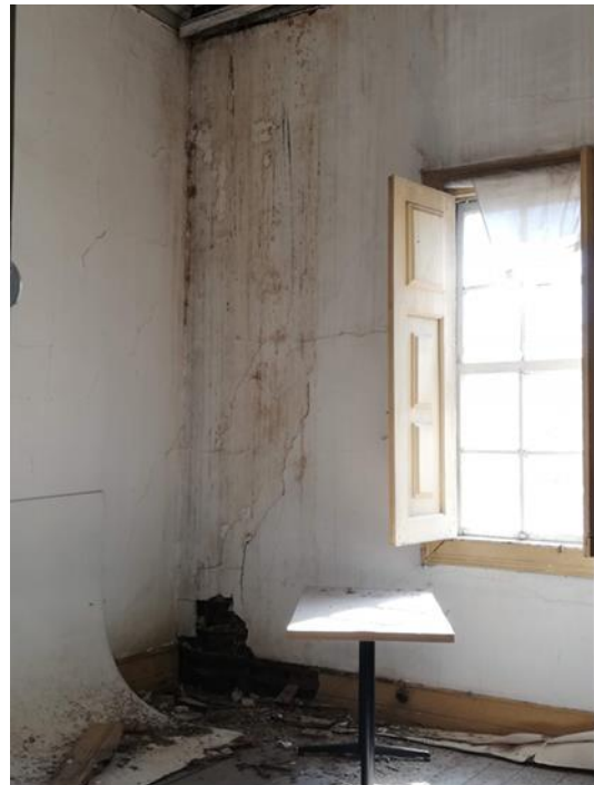
Figura 2.4 – Desagregação de reboco
