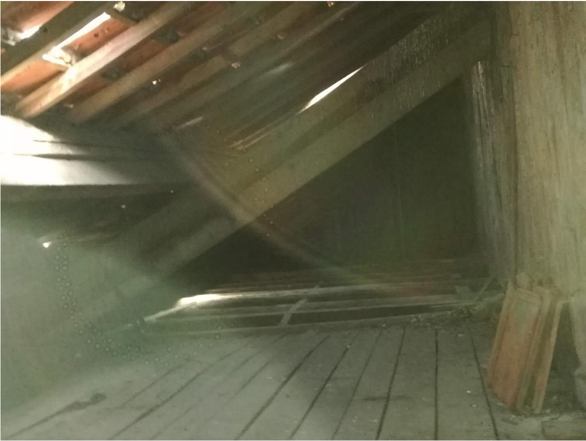
D10 – Estrutura e zona de infiltrações
