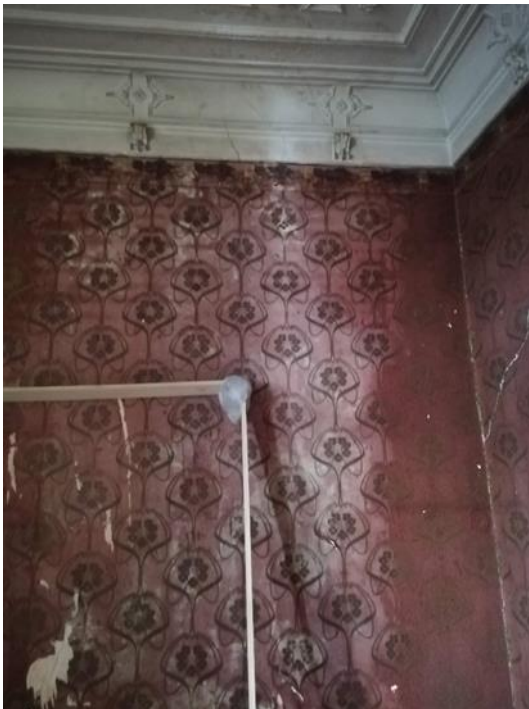
Figura 2.3 – Presença de humidades
