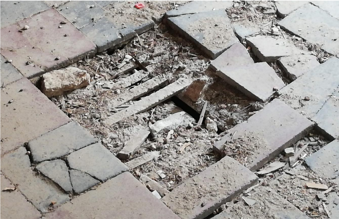
B21 – Desgaste de pavimento cerâmico
