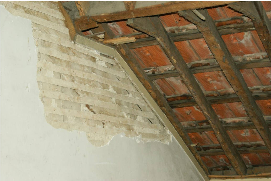
DO4 – Mau estado da estrutura
