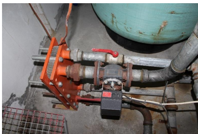
Figura 12 - Permutador para aquecimento da água da piscina.
