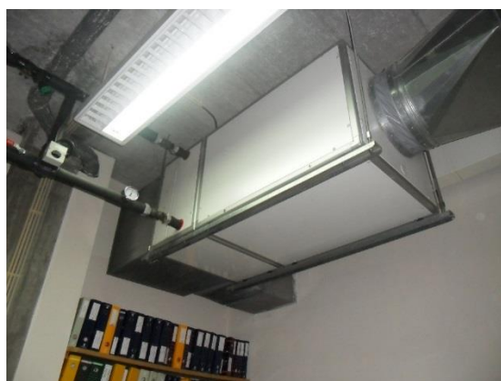
Figura 4 - Unidade de termoventilação, UTV6, situada no gabinete médico, piso 1.
