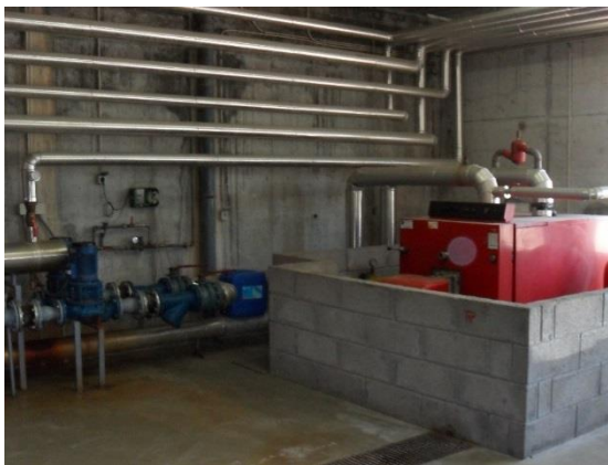
Figura 2 - Caldeira com queimador a gás natural, na sala das máquinas, piso 0.
