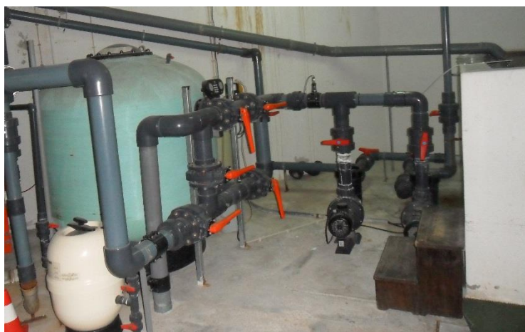
Figura 13 - Filtro e sistema de circulação entre o filtro e o tanque de compensação.
