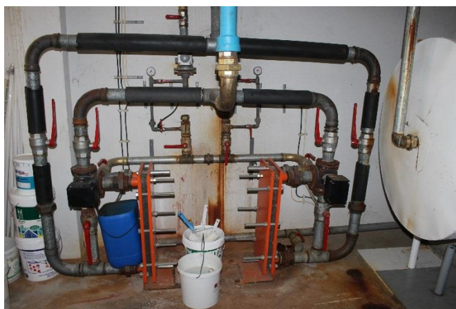
Figura 11 - Permutadores para produção de AQS, sala das máquinas.
