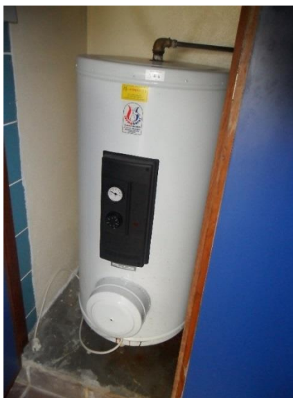
Figura 3 - Acumulador térmico elétrico que serve a sauna.
