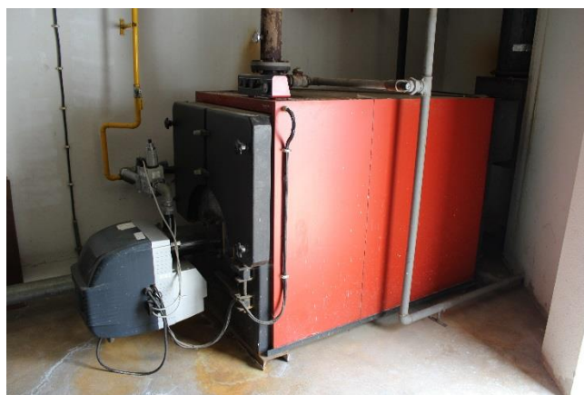
Figura 9 - Caldeira a gás propano, sala das máquinas.
