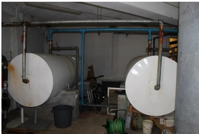
Figura 10 - Depósitos de acumulação de AQS, sala das máquinas.
