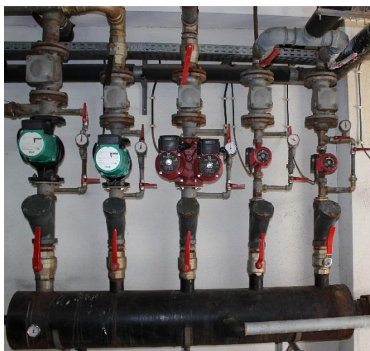
Figura 14 - Grupo de eletrobombas de circulação da água proveniente da caldeira.
