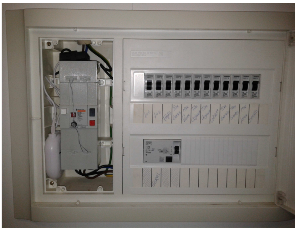
Figura 4.24 – Perspetiva geral do quadro elétrico.
