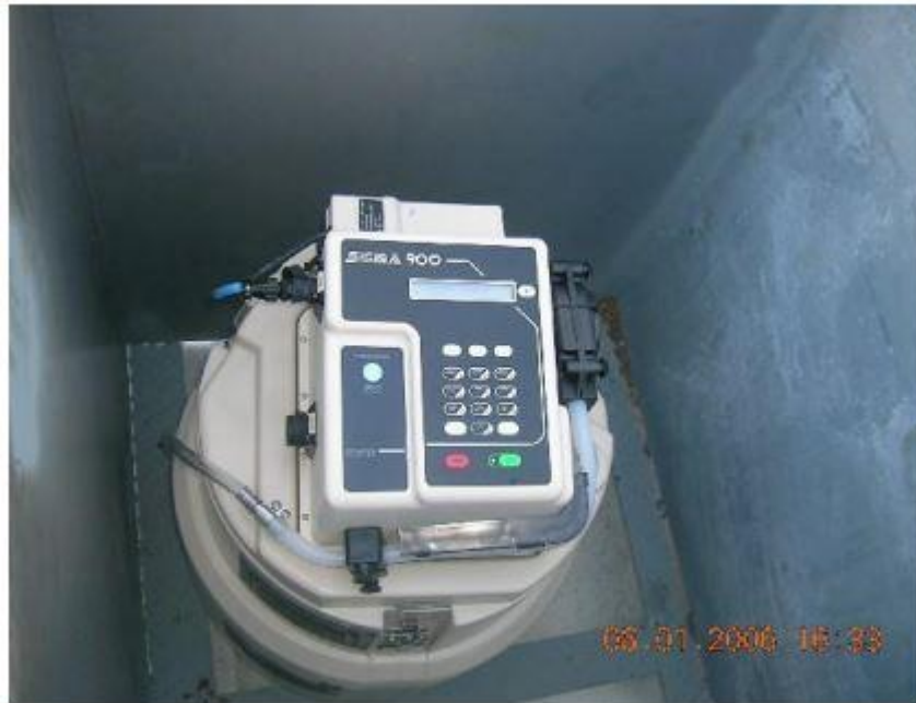
Figura 4.17 - Amostrador Sigma 9000 instalado à entrada da bacia
