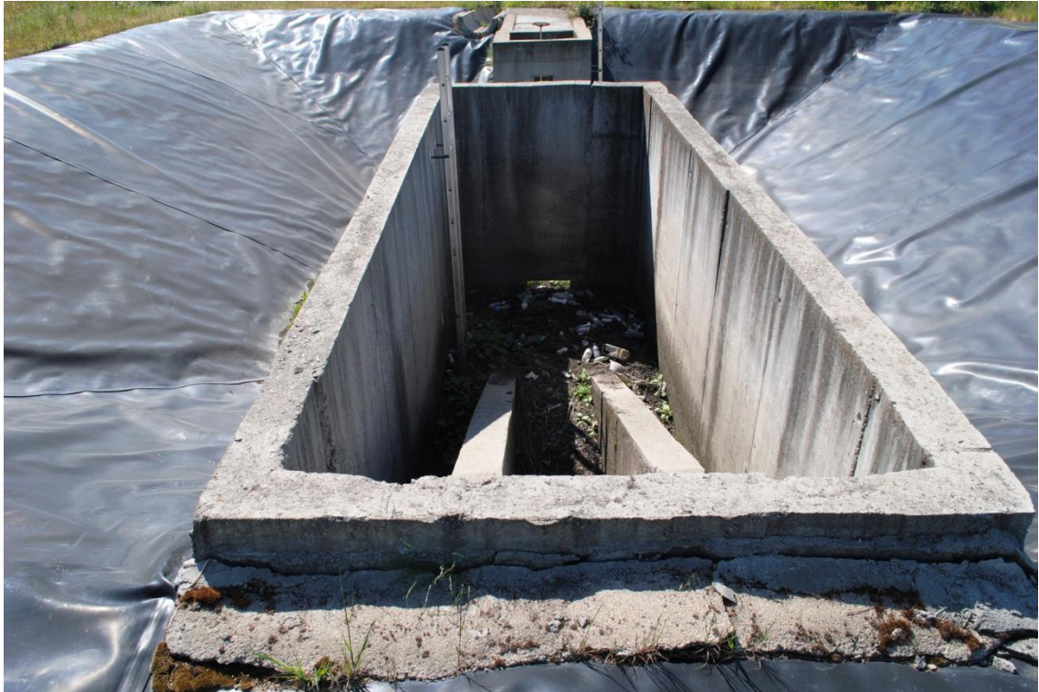
Figura 4.9 - Tanque separador de óleos e gorduras da bacia 3
