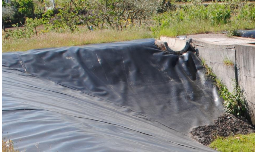
Figura 4.12 - Descarregador de segurança da bacia 3
