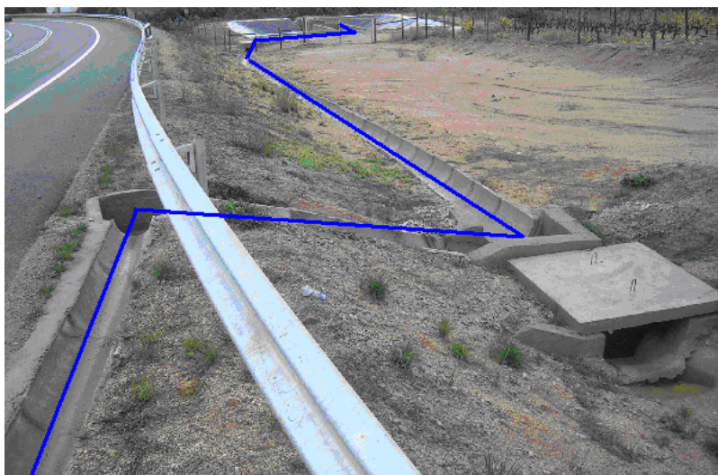
Figura 5.2 - Vista do sistema de interceção junto ao ponto 1 (Albuquerque, 2006)
