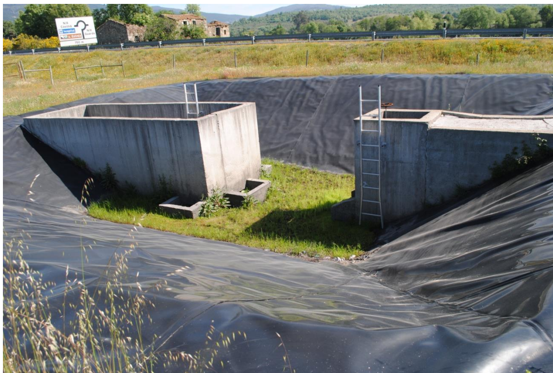
Figura 4.10 - Zona de decantação da bacia 3
