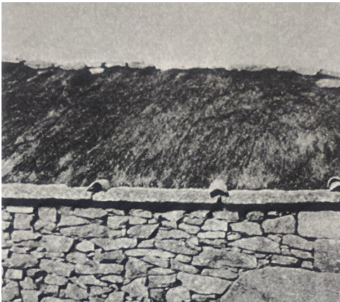
Figura 2.42: Cobertura Colmatada, Moura Morta - Castro de Aire
