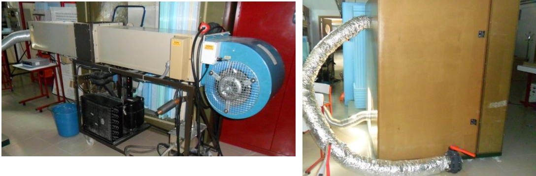
Fig. 49 - Unidade de tratamento de ar à esquerda e ligações dos ductos à câmara à direita.
