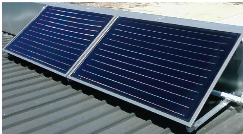
Figura 50 – Colectores instalados na cobertura.
