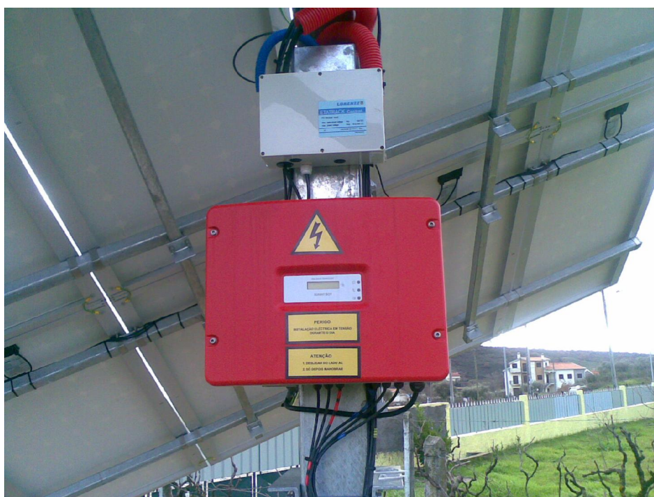
Figura 43 – Localização do inversor na instalação.
