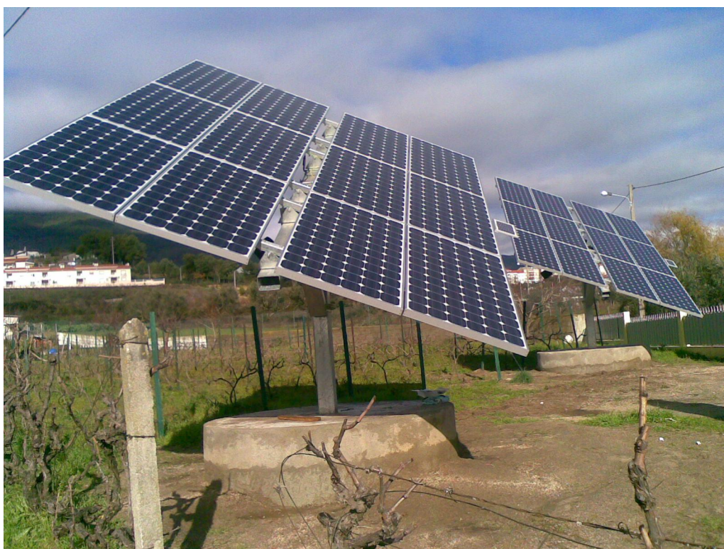
Figura 40 – Local da instalação.
