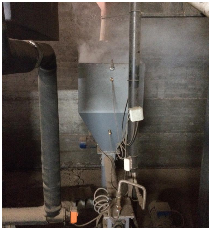
Fig. 28 - Silo que alimenta a caldeira automaticamente.
