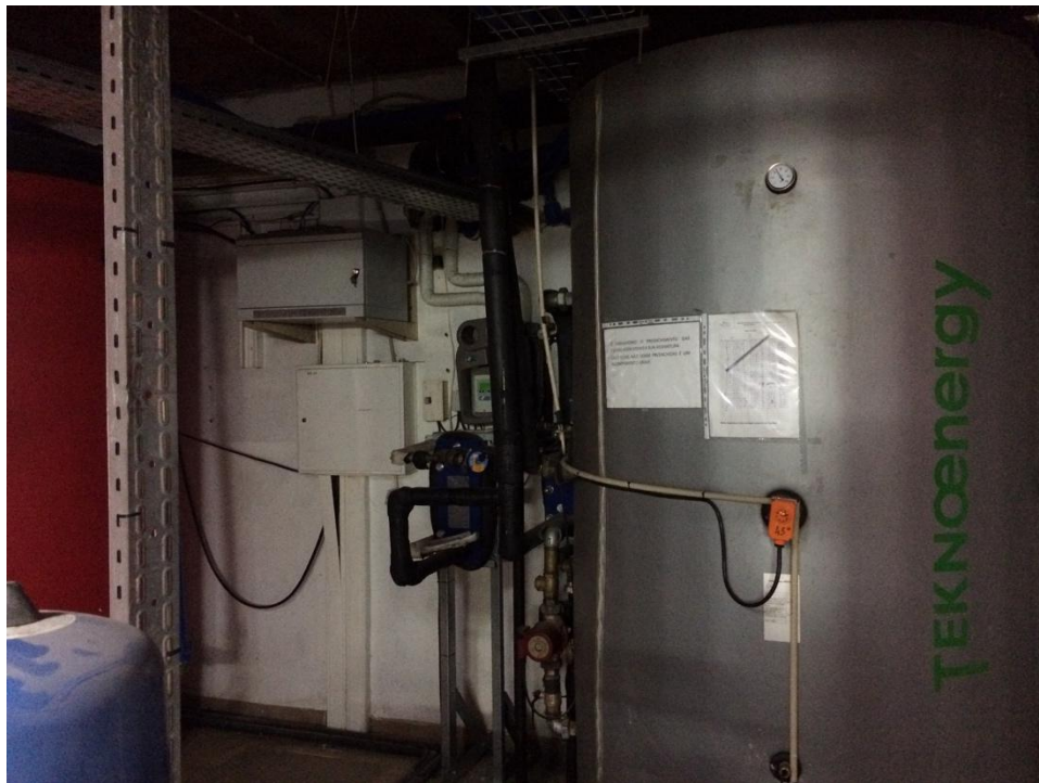
Fig. 31 - Cilindro de armazenamento de AQS instalado no hotel.
