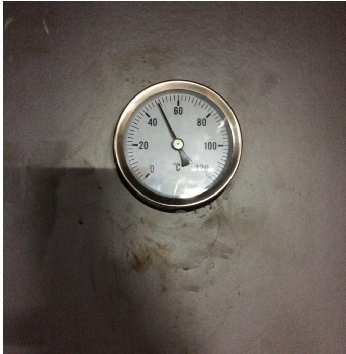
Fig. 32 - Termômetro de um dos cilindros de armazenamento de AQS.
