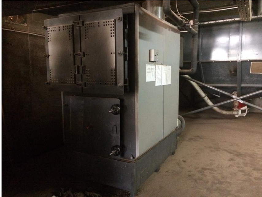
Fig. 27 - Fotografia da caldeira a biomassa instalada na casa das máquinas no hotel.
