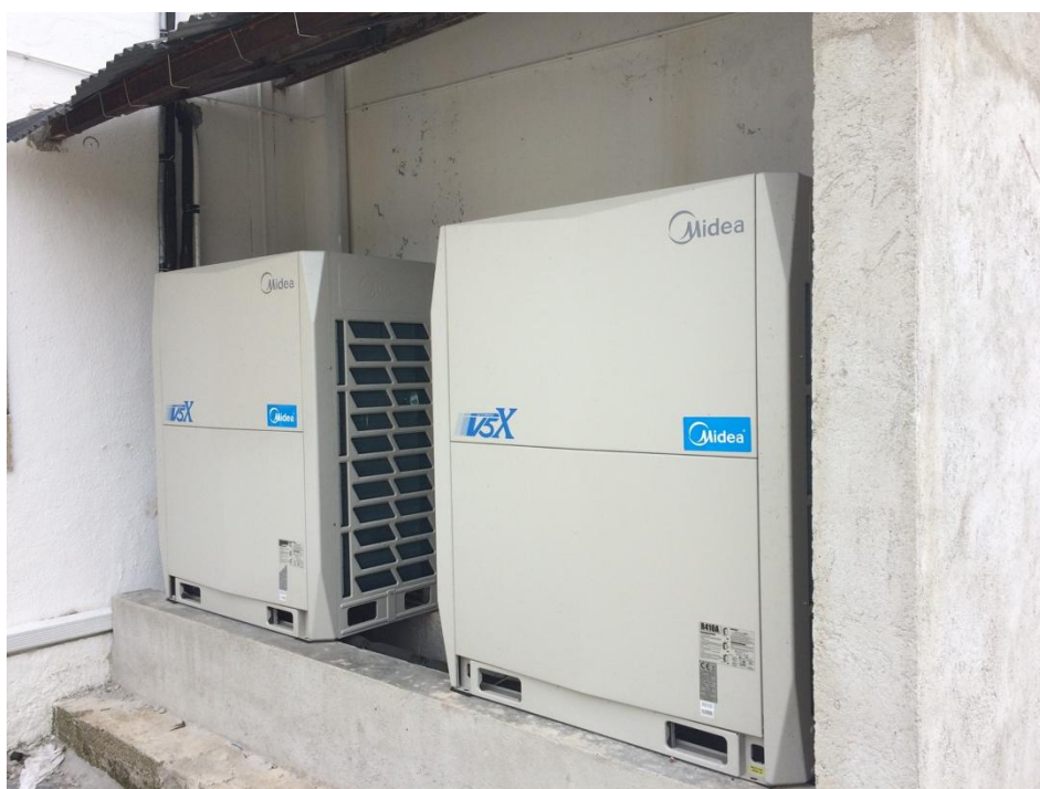
Fig. 35 - Localização das unidades externas de ar condicionado.
