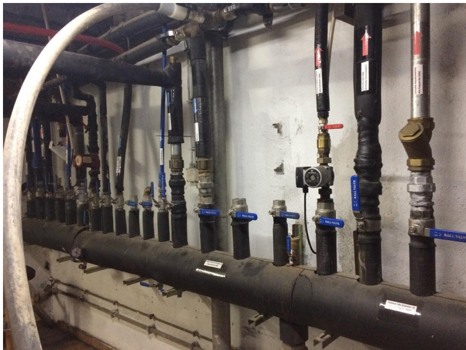
Fig. 38 - Tubagens e válvulas existentes na casa das máquinas.
