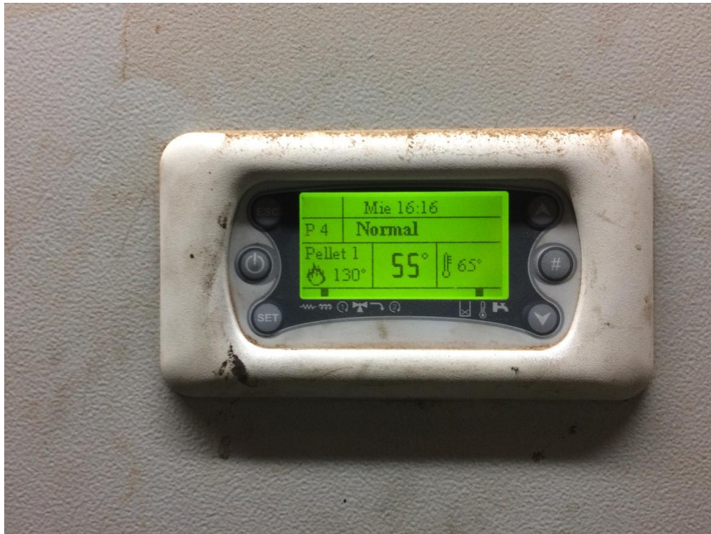
Fig. 29 - Display do quadro de controlo da caldeira.
