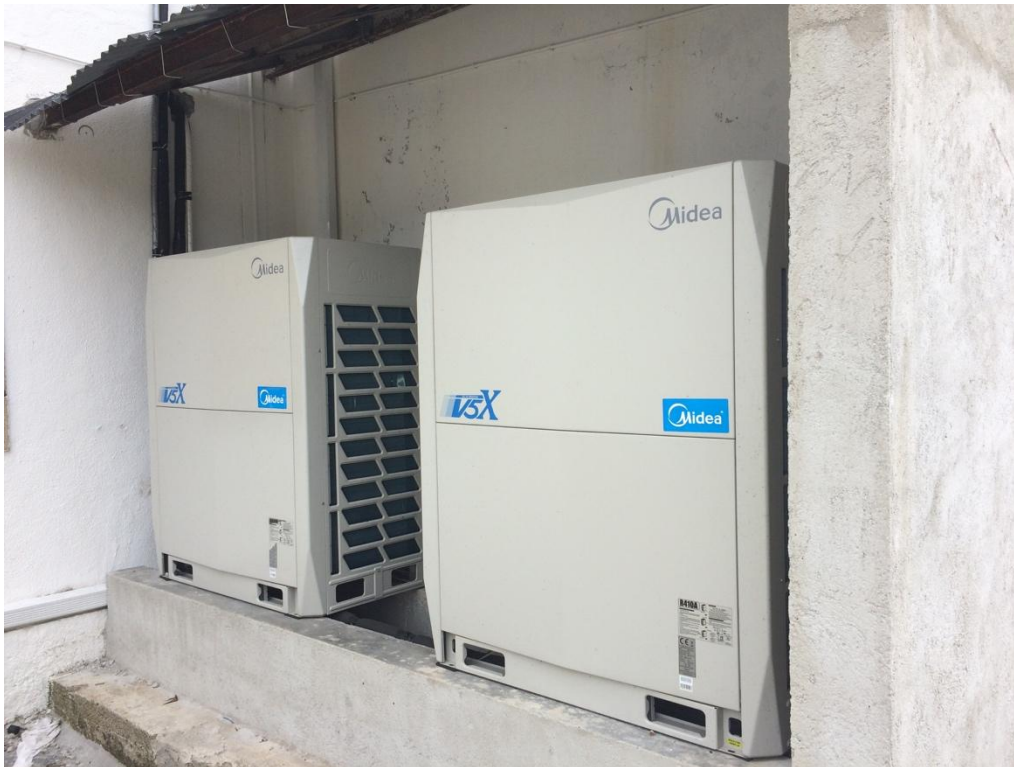
Fig. 24 - Módulos de AC instalados na ala centro do hotel.
