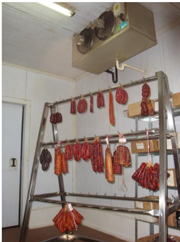
Figura 24 - Interior de câmara de frio da empresa C.
