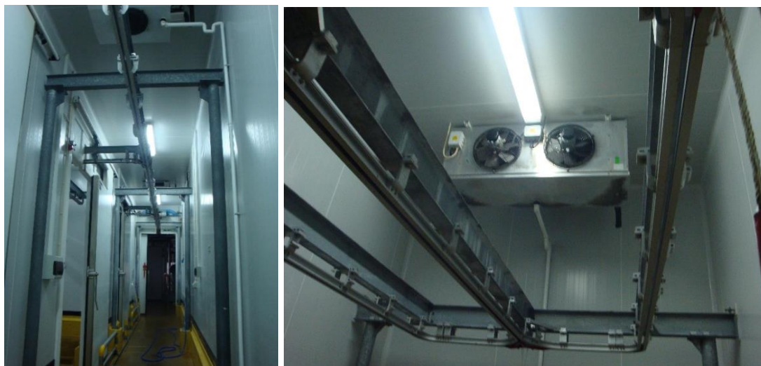
Figura 22 - a) Corredor climatizado da empresa A; b) Evaporadores de uma câmara de frio.
