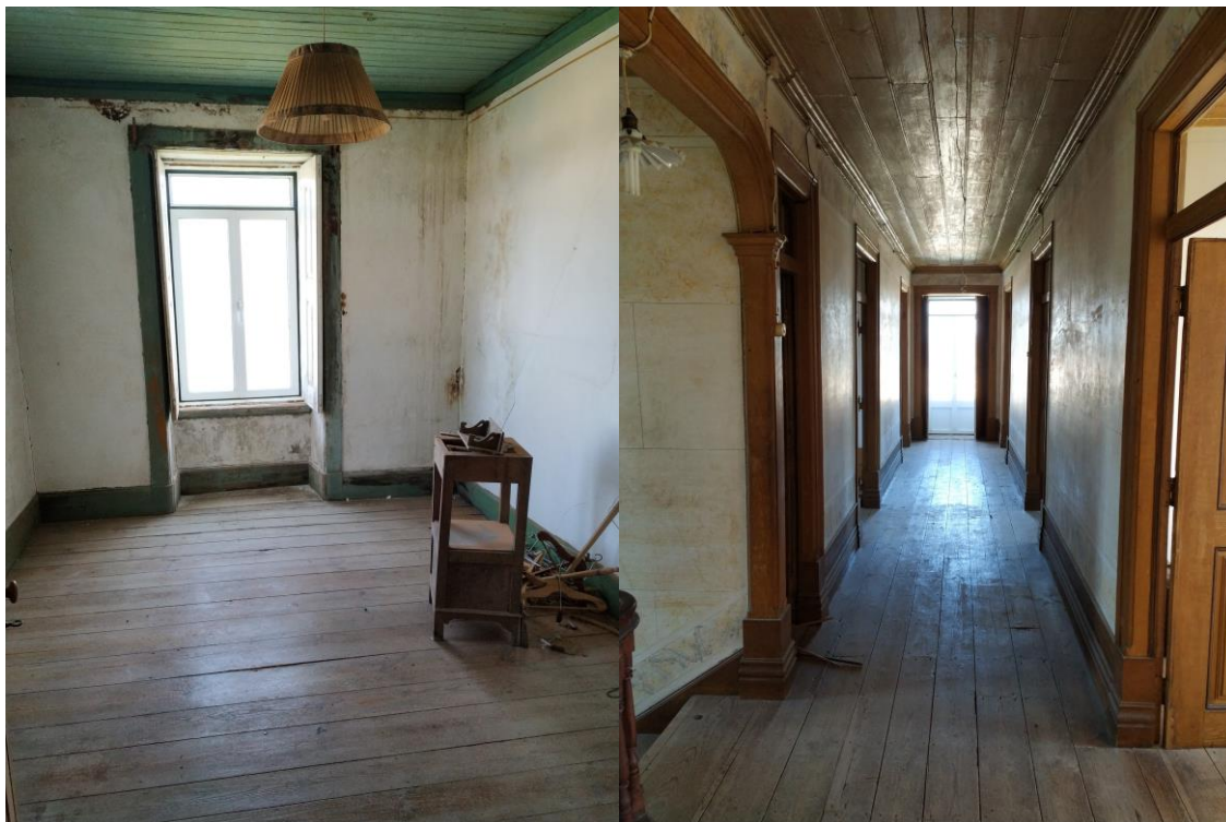
Figura 27 - Vista do Interior degradado da Casa
