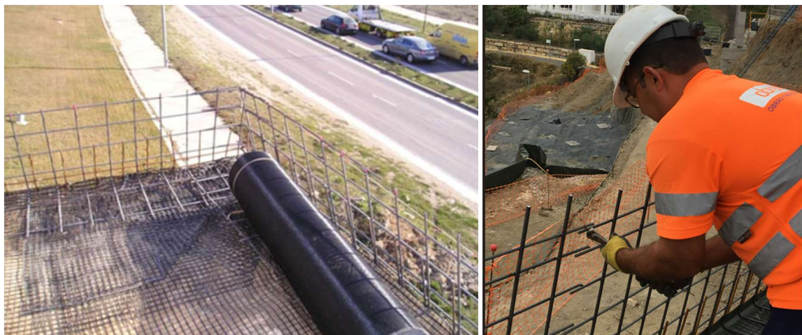
Figura 4.6-a) Pormenor da colocação dos painéis de malha de aço; b) Amarração da malha de rede verde
