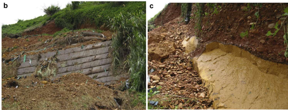
Figura 3.5-Falha do talude reforçado na Seção C-C devido a chuvas intensas induzidas por tufão em 2004:
