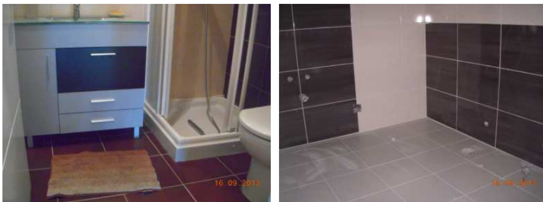
F.107. Fotografias do Caso de Estudo - Instalações Sanitárias.
