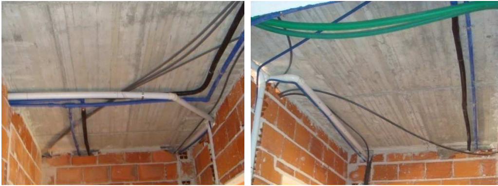
F.111. Fotografias do Caso de Estudo - tubagens, rede de água, rede eléctrica, rede de ITED (dados, som e imagem), rede de aspiração central.
