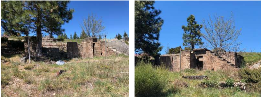
Figura 4.2.4 Abrigo 1 em ruína, com escadaria que pode ser reutilizada, (foto de autora, 2024).
