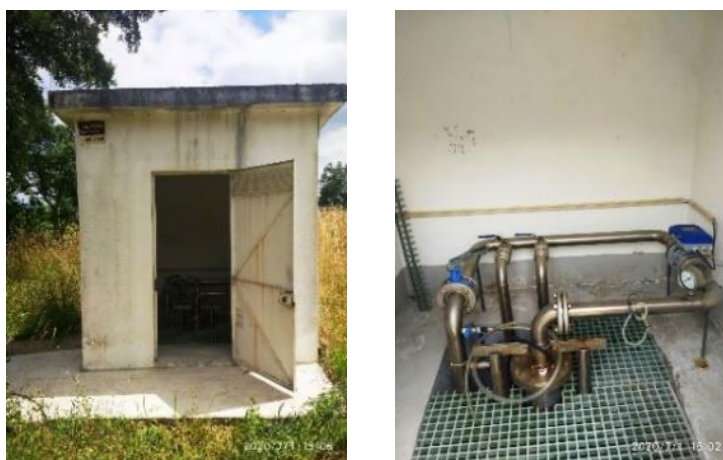
Figura 29 - Esquerda: aspectos da caseta de protecção do Furo de Barbeitos; Direita: Interior da caseta e boca do Furo de Barbeitos.
