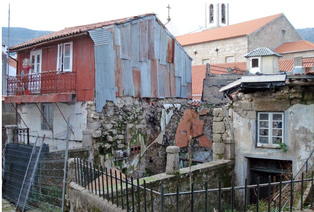
Figura 15. Conjunto habitacional em avançado estado de ruína, Covilhã.
