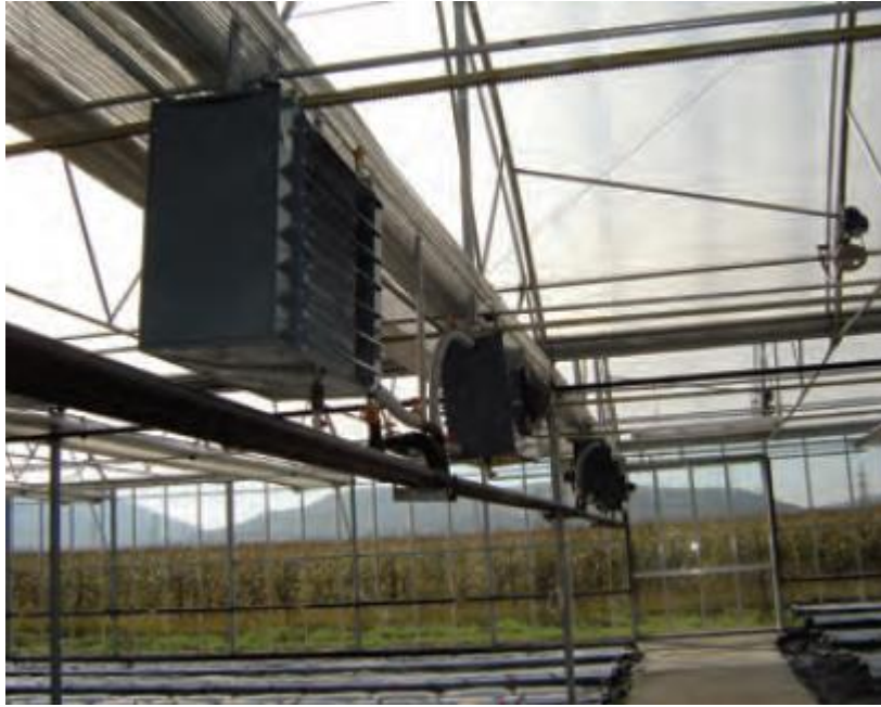
Figura 2.5 - Unidade de aquecimento de ar [11].
