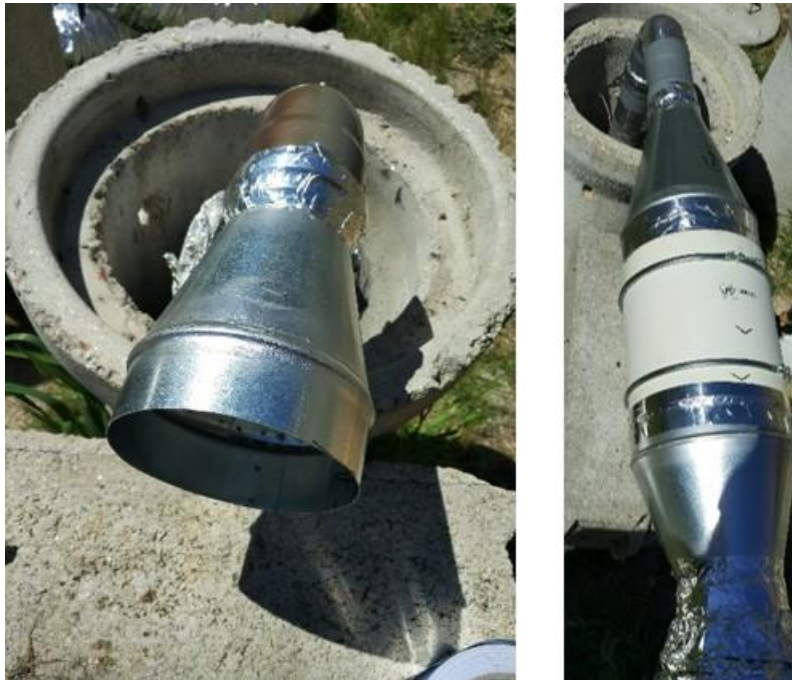
Figura 3.20 - Fotografia dos acessórios de ligação entre saída permutador e tubo isolado (esquerda) e acessórios de ligação entre permutador, ventilador e tubo isolado (direita)
