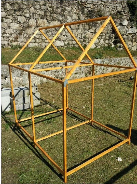
Figura 3.4 - Fotografia da estrutura da estufa
