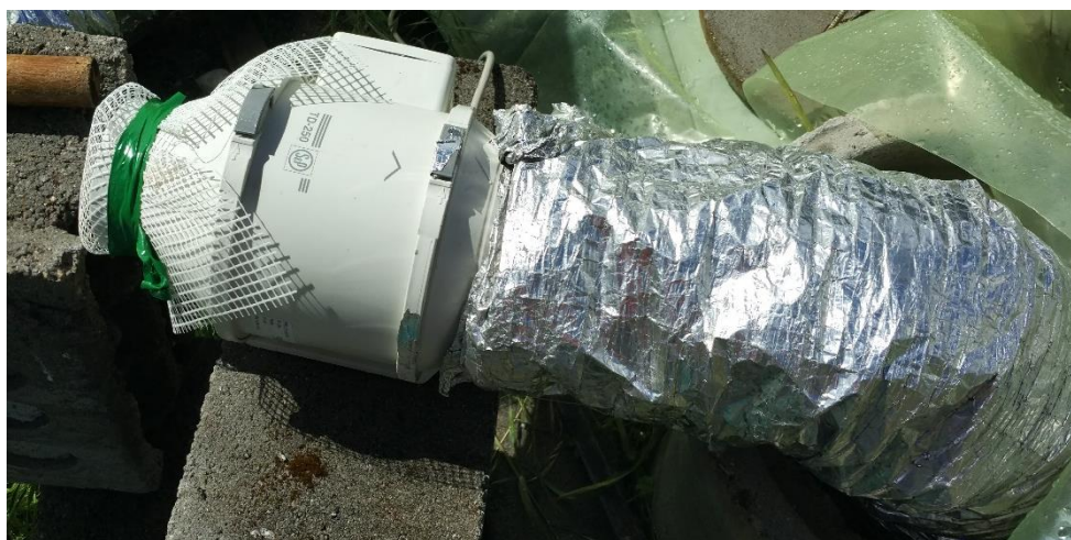
Figura 3.34 - Fotografia do segundo ventilador no permutador de calor
