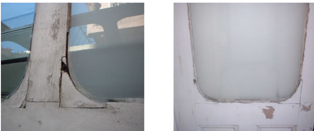
Figura 4.20 - Perda da massa de fixação dos vidros e apodrecimento dos caixilhos
