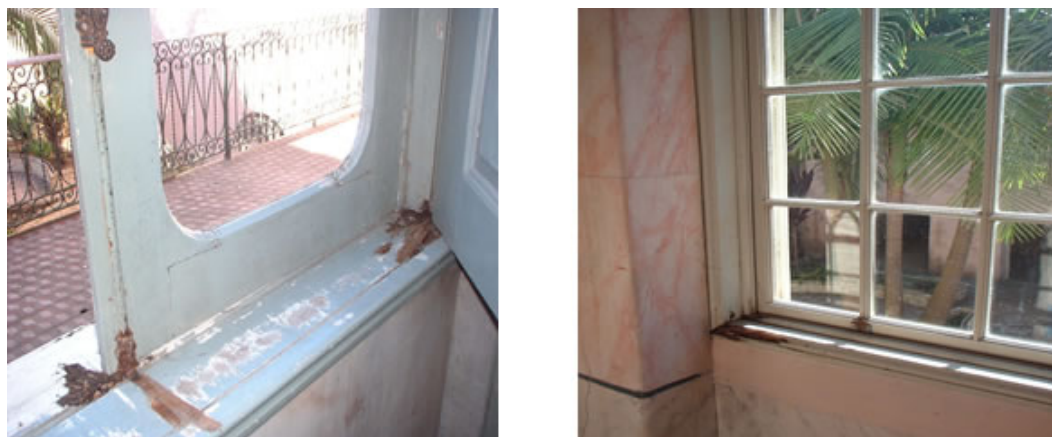
Figura 4.18 - Apodrecimento interno das esquadrias
