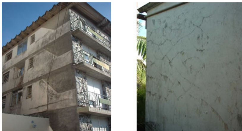
Figura 1.2 -Manchas de sujidade e fissurações
