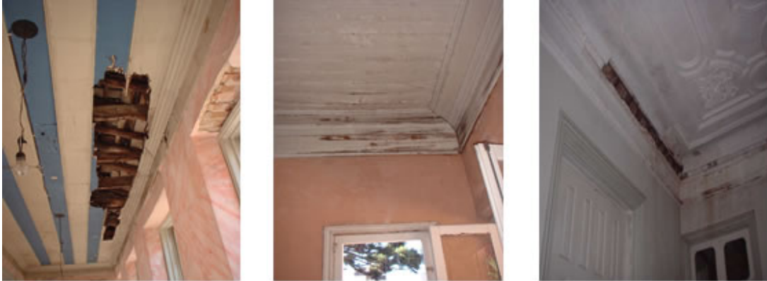
Figura 4.28 - Infiltrações nos tetos e paredes
