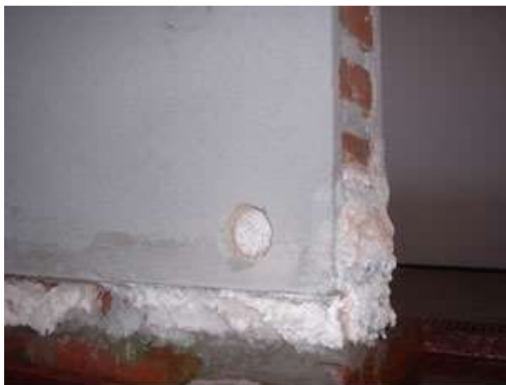
Figura 7.80 -Reboco 1:1:7 CHB - Formação eflorescente no local donde foi extraída amostra do reboco
