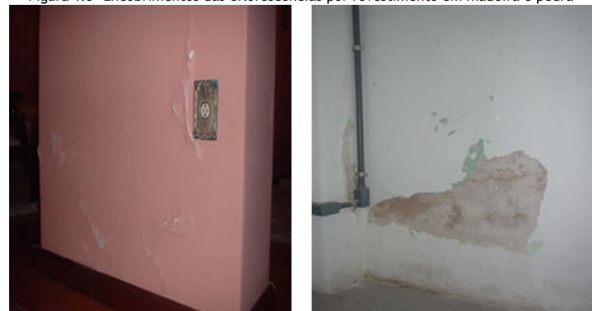
Figura 1.6 -Agravamento das eflorescências pelo uso inadequado de materiais na construção e/ou recuperação
