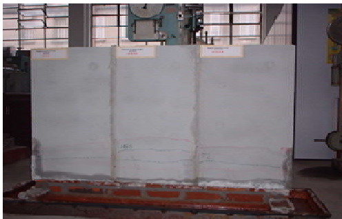
Umidade e eflorescências após 48h
