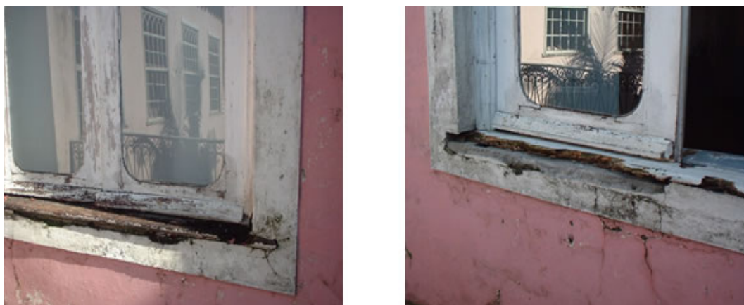
Figura 4.19- Apodrecimento externo das esquadrias
