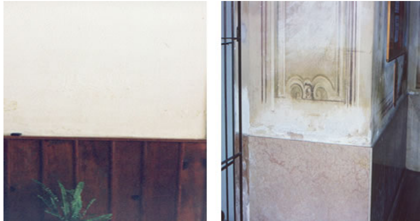
Figura 1.5 -Encobrimentos das eflorescências por revestimento em madeira e pedra
