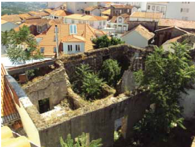
Foto 9 - Edifício em Ruína
