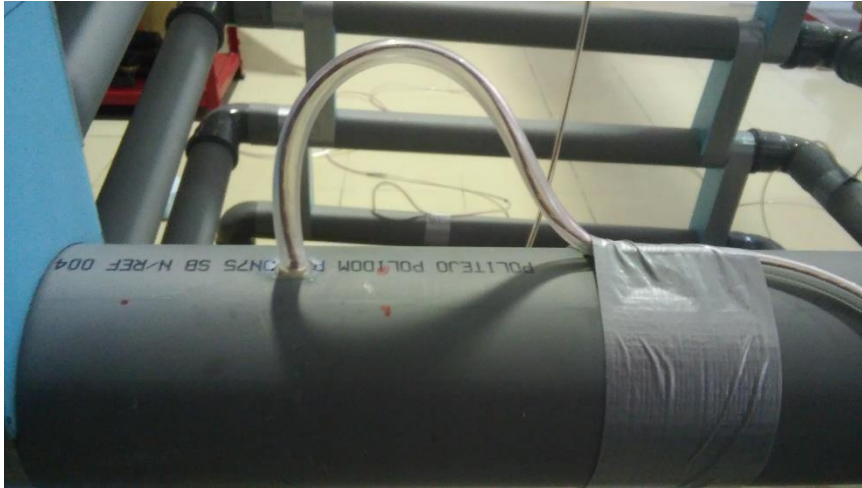
Figura 4.7 - Pormenores da instrumentação do permutador.
