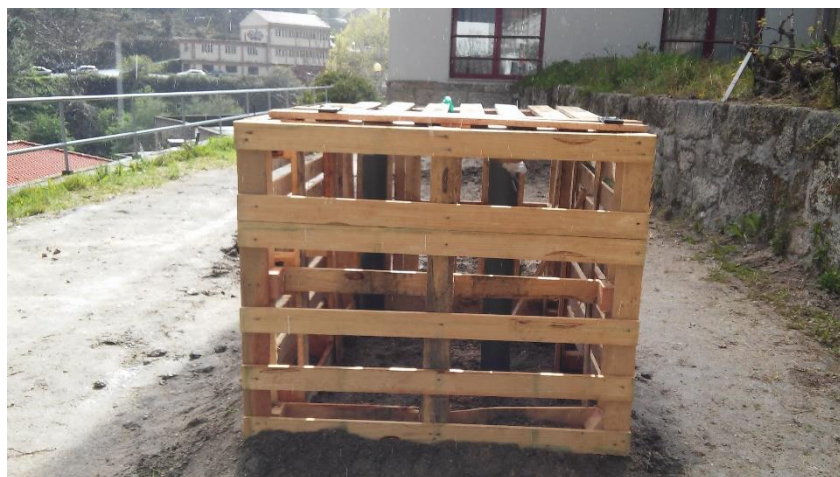
Figura 4.16 - Fotografia do invólucro protetor contruído para proteção bas bocas do permutador.
