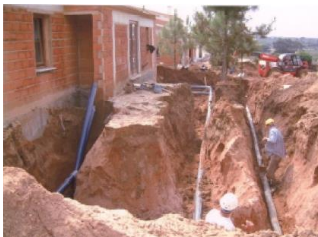
Figura 3.11 - Implementação do permutador de calor na ‘Casa Borboleta’ (Gonçalves & Nascimento, 2004).
