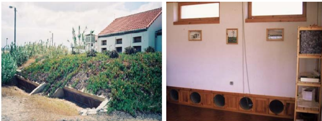
Figura 3.15 - Pormenores relativos a localização das bocas de admissão de ar (à esquerda) e das bocas de saída para o interior do edifício (à direita). Adaptado de Gomes (2010).
