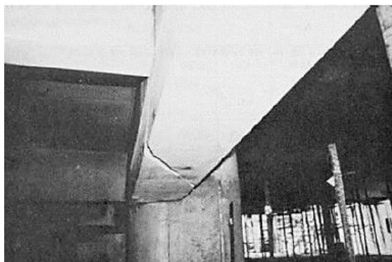
Figura 3. Rotura frágil por torção de uma viga num edifício [56].
