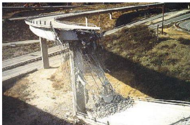
Figura 34. Colapso estrutural de uma ponte rodoviária com eixo curvo [85].
