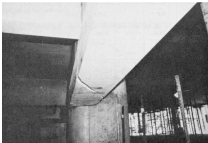
Figura 1.3 - Rotura por torção numa viga de um edifício [16]
