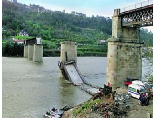
Fig. 1.1 - Colapso da ponte de Entre-os-Rios, em Portugal [www.josecarlosilva.wordpress.com, acedido em 24-03-2011]
