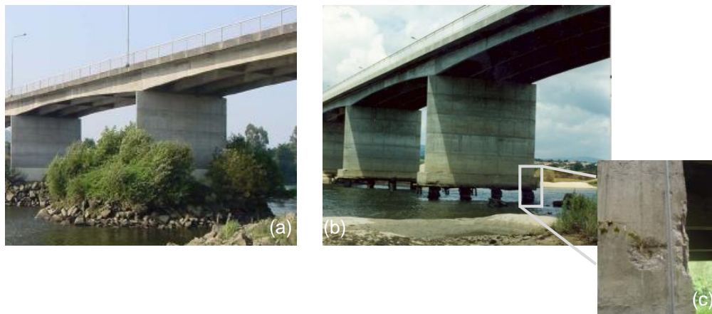
Fig. 1.2 - Ponte de Lanheses (a) antes, (b) após a ocorrência do processo erosivo junto dos pilares e (c) pormenorização da degradação do elemento estrutural (adaptado de PINHO 2010)
