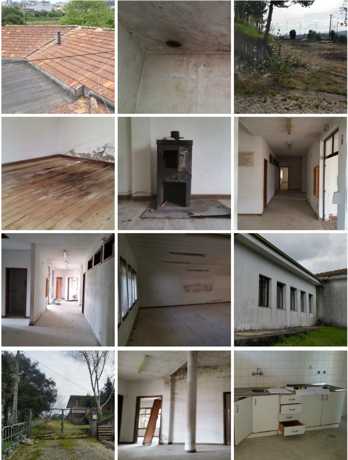
Figura_2.6 - Registo fotográfico dos problemas do edifício.
