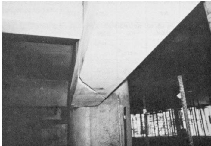
Figura 1.6 - Rotura Frágil com Fenda Helicoidal devido a Torção de uma Viga [13]
