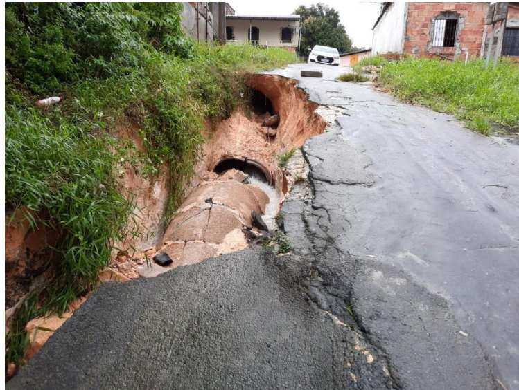
Figura 11 - Rompimento da Rede de drenagem
