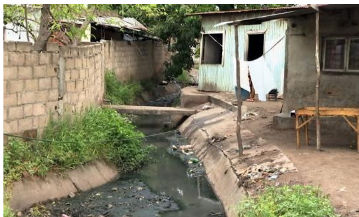
Figura 14 - Estado precário em assentamento informal em Maputo, Moçambique (Noticias AI, 2017)
