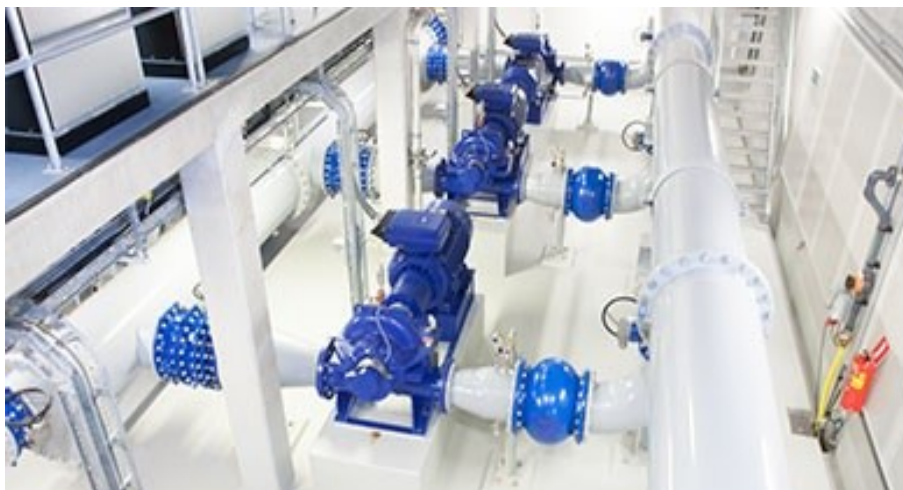
Figura 1.7: Aplicação do SynRM numa estação de bombeamento de águas [28].
