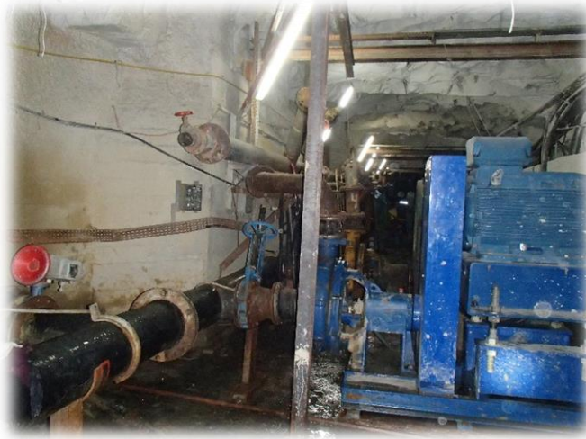
Figura 1.4 - Estação de bombagem, no interior da mina.
