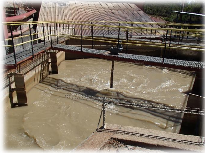
Figura 1.6 - Tanque de recepção.
