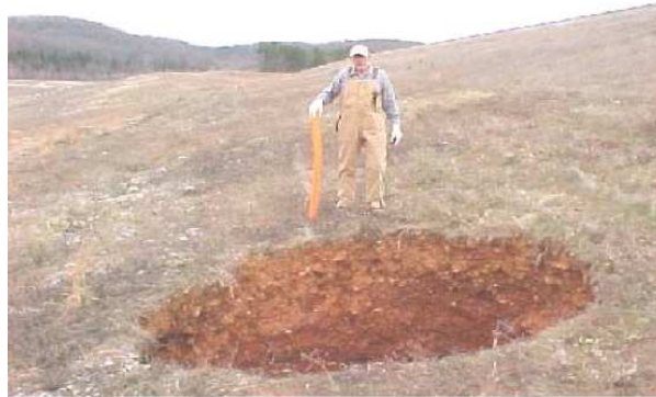
Figura 2-27 Exemplo de chaminé em aterro de barragem com fundação em terrenos cársicos (Schaefer, 2009).
