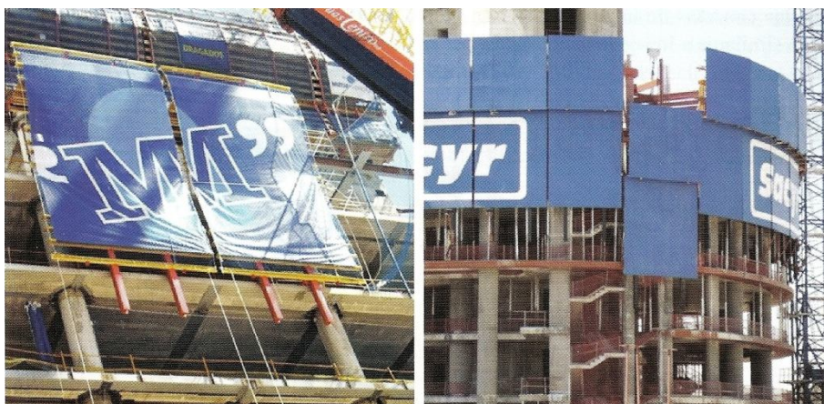
Figura 5.28 – Módulos de protecção de fachada na Torre de Cristal e Torre Sacyr-Vallehermoso (Hermoso, 2005)
