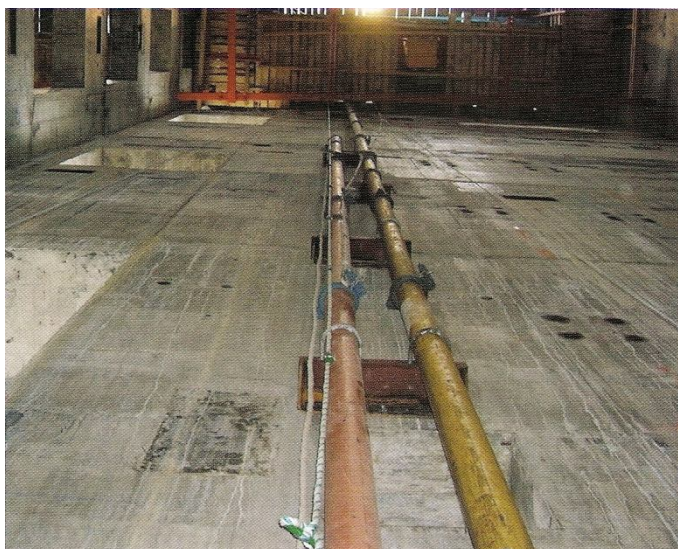
Figura 7.17 – Tubagem de serviço e reserva fixada no núcleo de rigidez (Sainz, 2006)
