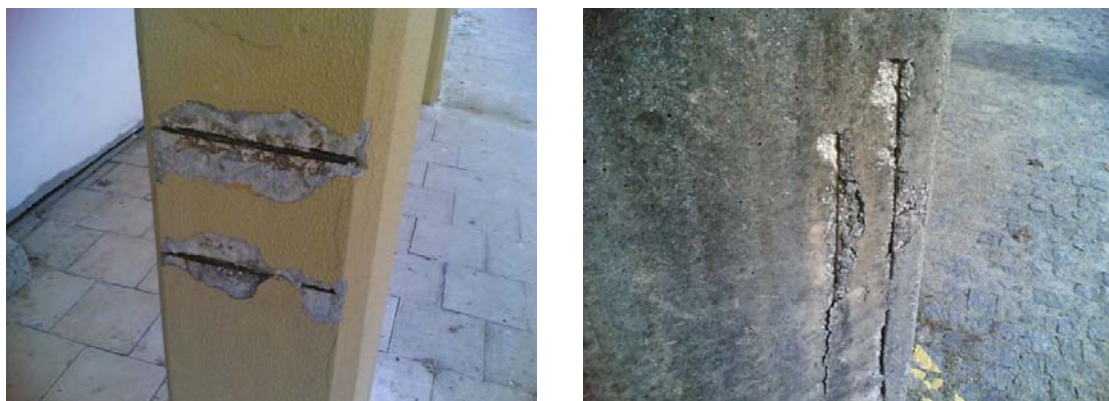
Figura 15 - Exemplo de destaque do betão provocado por oxidação do aço [F16].
