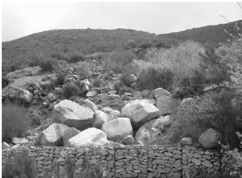
Figura 35 - Queda de blocos EN338.
