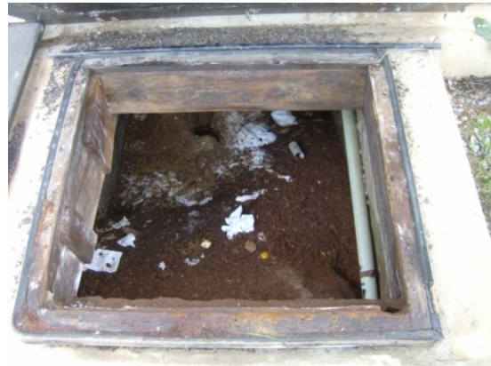
Figura 77 - Interior da câmara de compostagem (Eco-Aldeia Tâmera) 89
