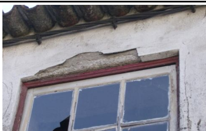
Quadro 4 - Anomalias da fachada exterior
