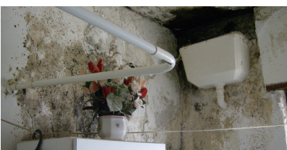
Quadro 9 - Anomalias do pano interior das fachadas exteriores
